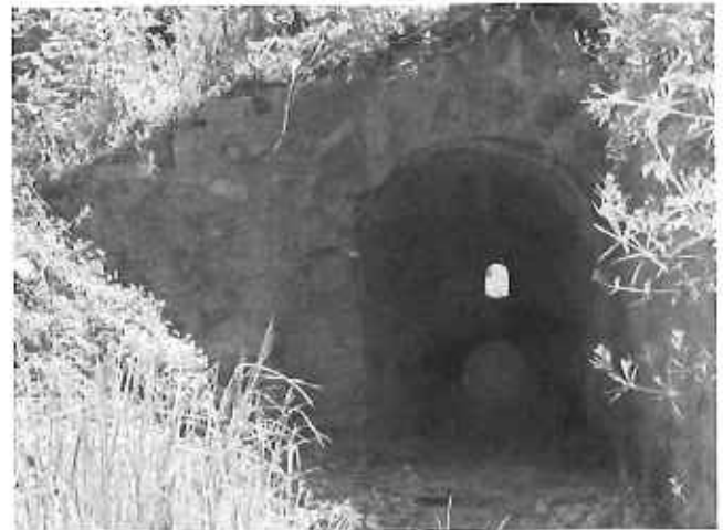
Photo 13 : ouvrage hydraulique au niveau du point bas de la RN1, bois Carreau.
